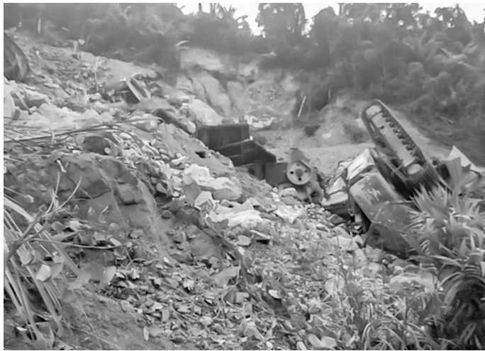
● Thủy điện Rào Trăng 3 vẫn còn ngổn ngang đất đá.
